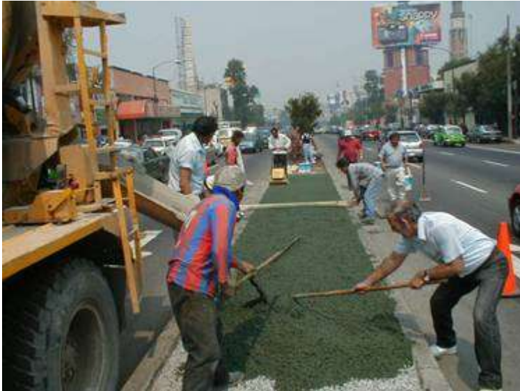
Mezcla proporcionada por una empresa concretera. OBRA: Camellón Av. Revolución, México, D. F.
